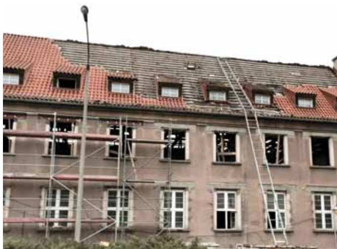
▲ Dach częściowo pokryty
